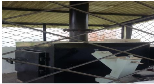
Gambar 4. Tempat Pembakaran Limbah ( Incinerator )
